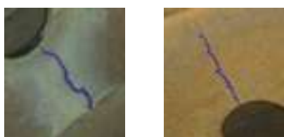
(a) 裂纹 1 放大图 (b) 裂纹 2 放大图
