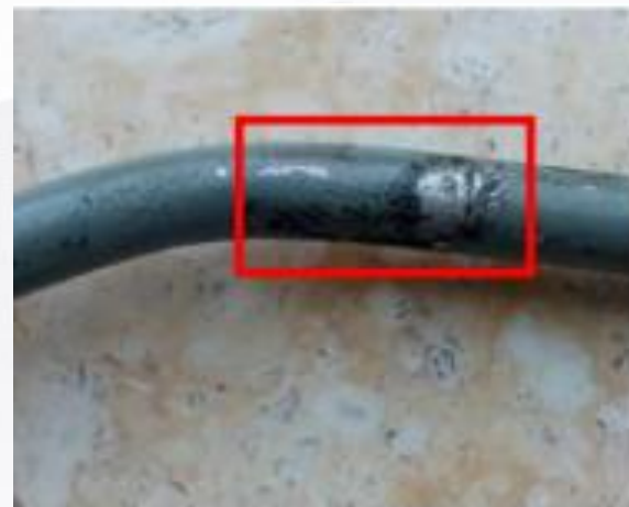
管路碰摩损伤
