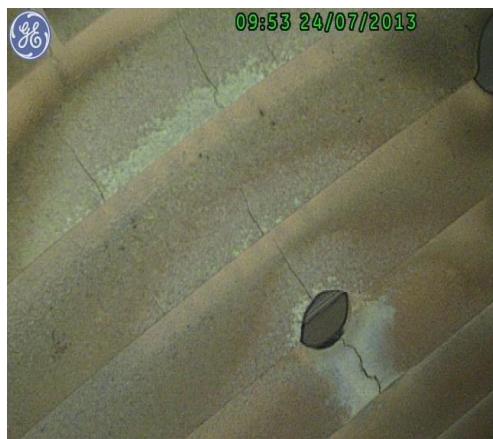
(图 c) 燃烧室机匣裂纹
