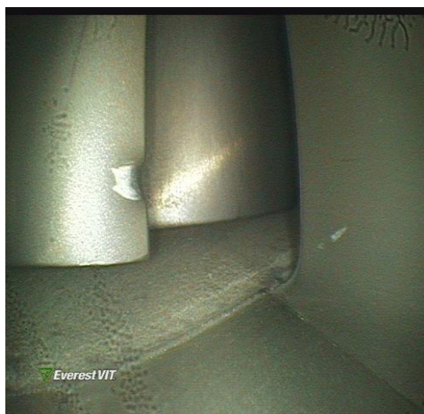
(图 b) 压气机叶片刮伤
